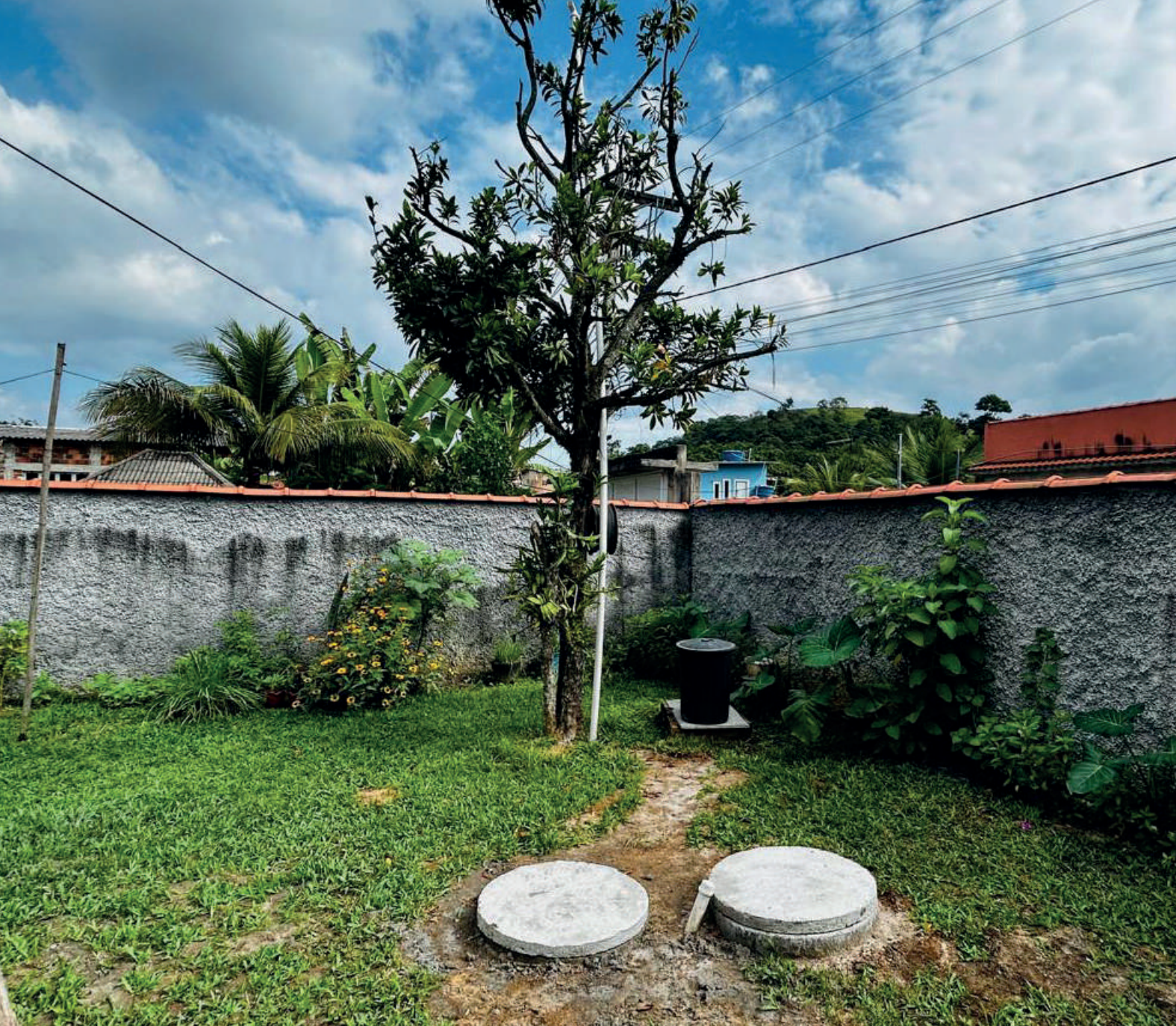
Biodigestor instalado em quintal de residência no município de Itaboraí - Acervo
