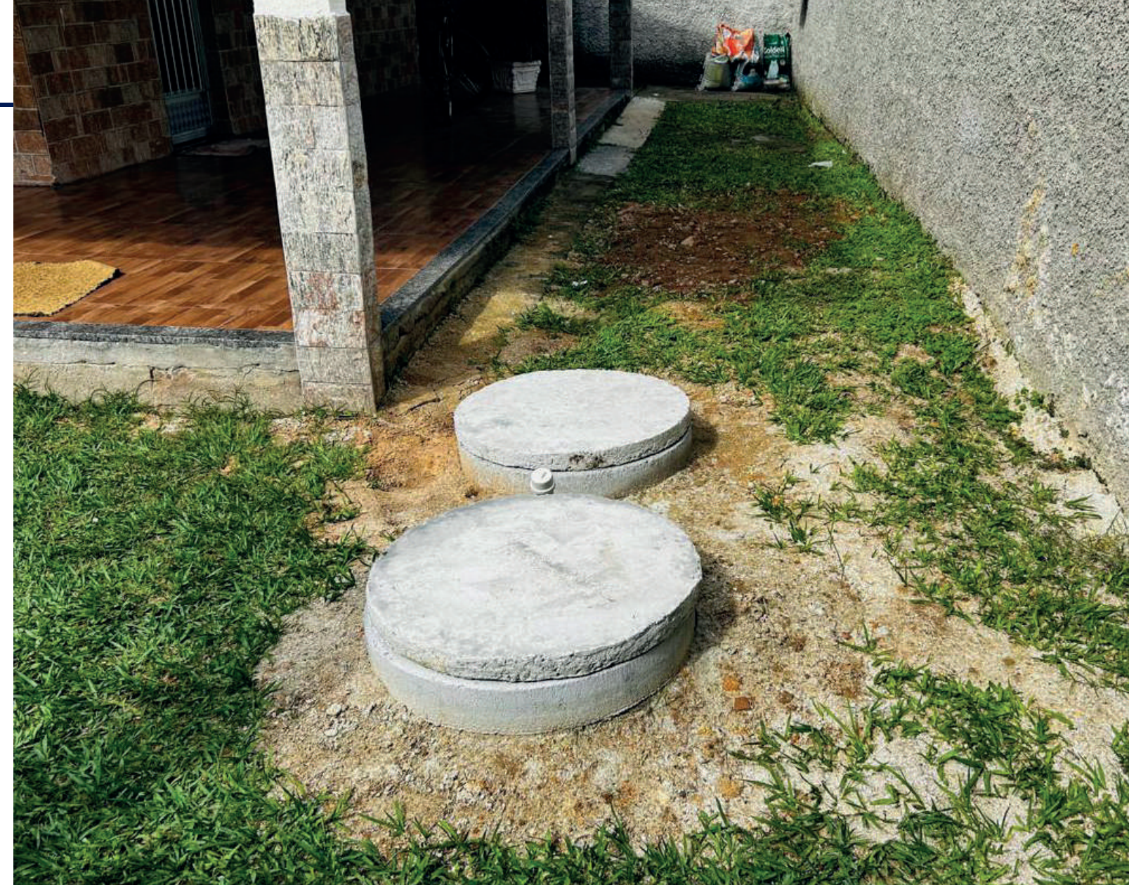
Biodigestor instalado em quintal de residência no município de Itaboraí – Acervo
